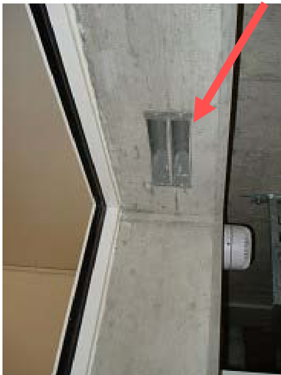
Planungsfehler: Leerrohre für Zargeneinbau
